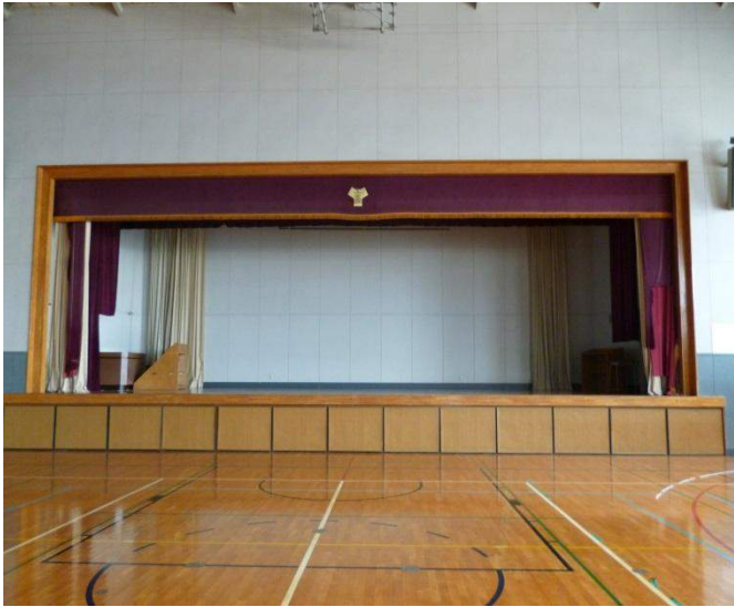
劣化した舞台幕 交換前
